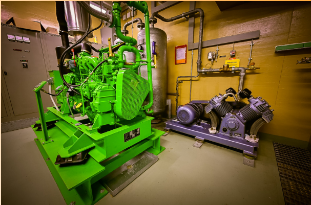
SALLE DES MACHINES
